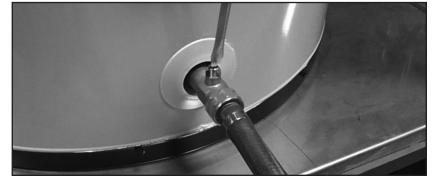
Figura 37 - Válvula de drenaje.
