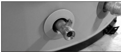
Figura 45 - Válvula de drenaje.
