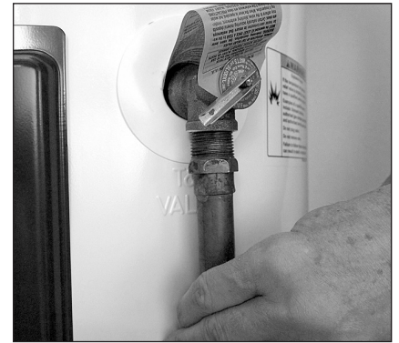
Figura 15 - Se debe instalar correctamente la tubería de descarga de la válvula de alivio de T y P, y se debe canalizar hasta un drenaje adecuado.
