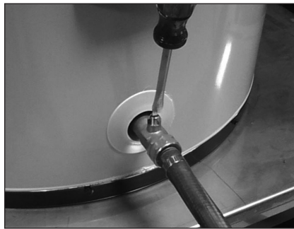
Figura 11 - Drenaje del calentador de agua antiguo.
