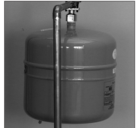
Figura 6 - Un tanque de expansión térmica ayuda a proteger el sistema de plomería de la casa contra los incrementos de presión.
